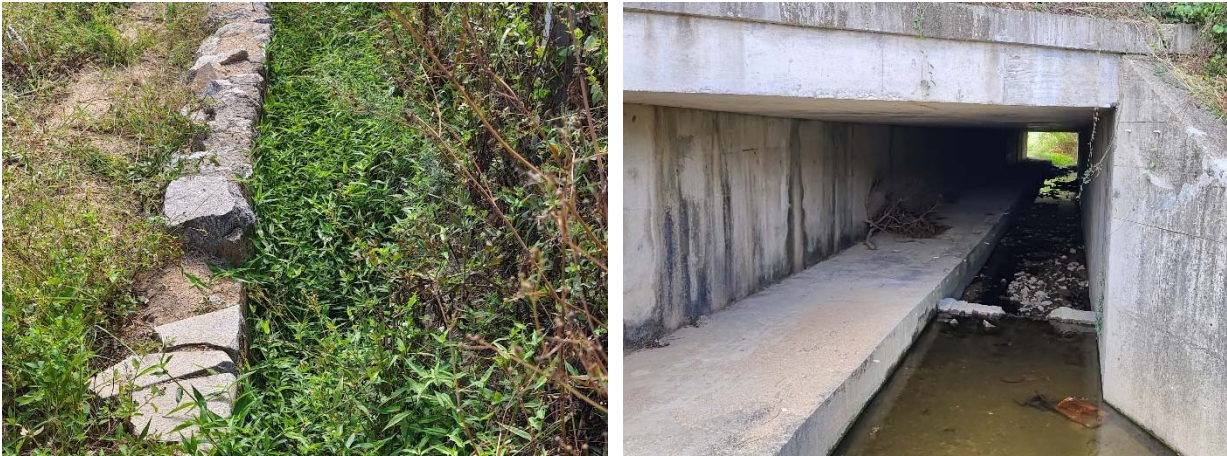
排水沟损坏及桥下排水沟淤积、发臭
