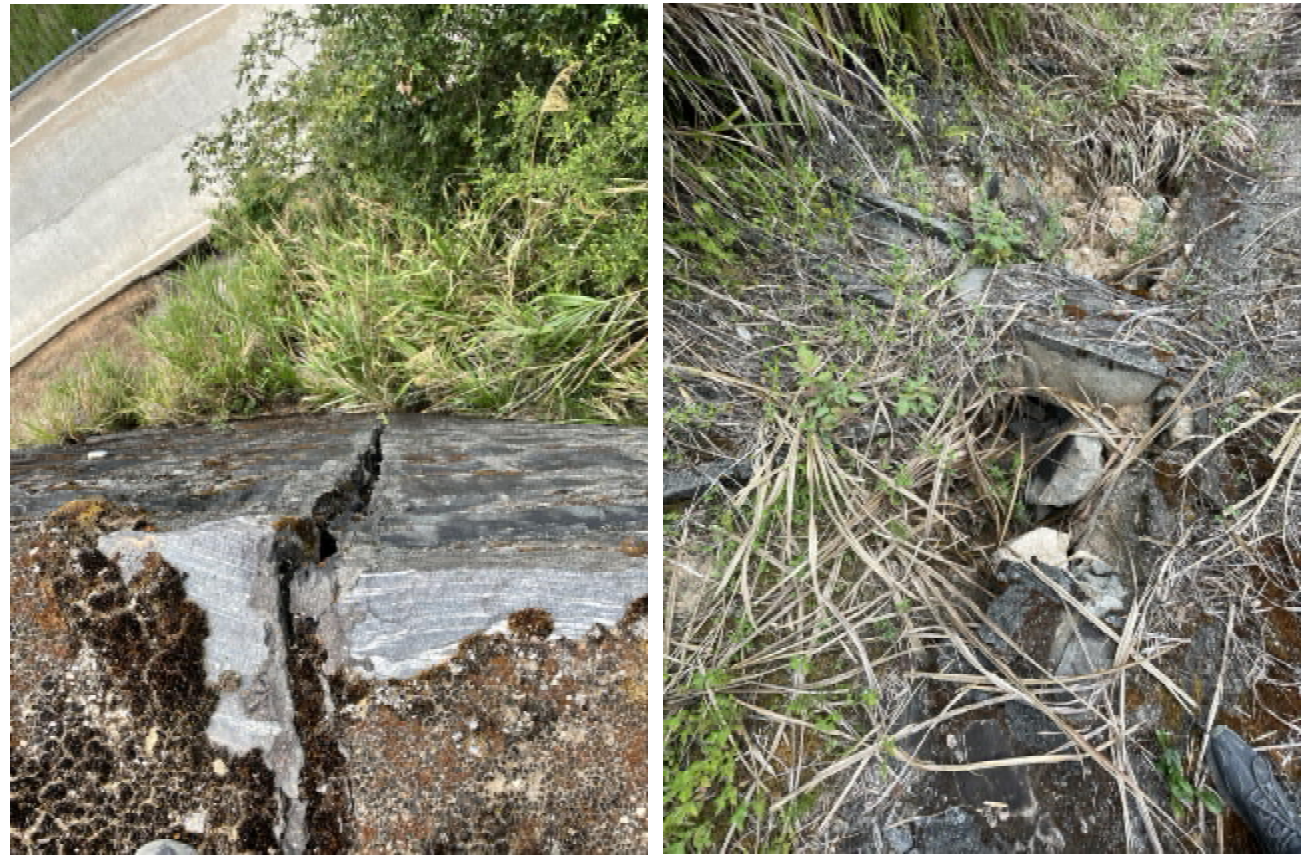
图 6、7.墙顶错缝损坏
