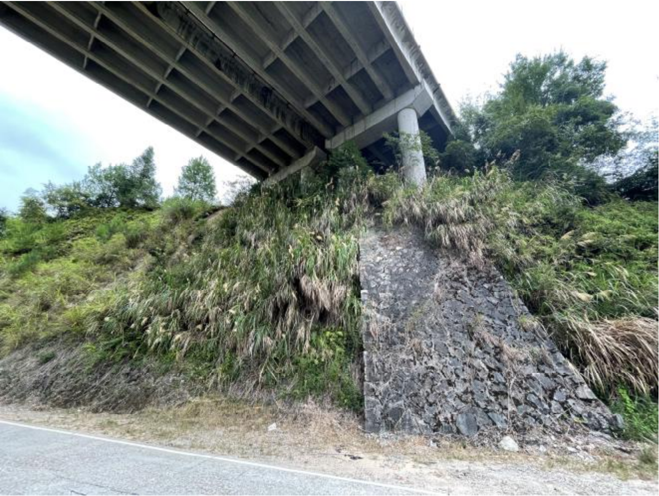
图 8.桥墩下护面墙损坏
