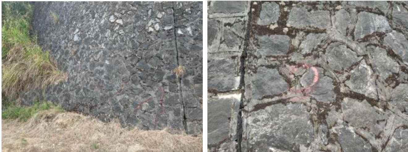
图 2、3.墙面开裂松动
