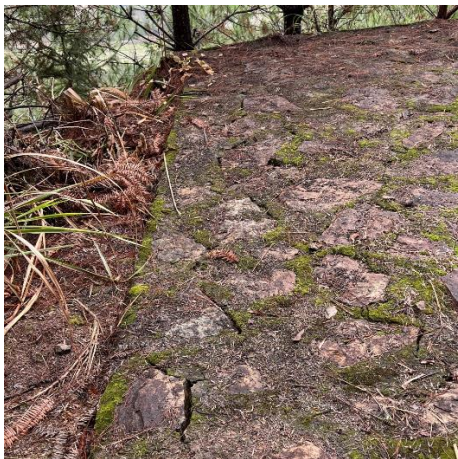
图 4 第五阶平台开裂
