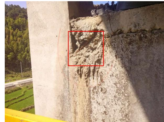
图 3-13: 峨嵋峰大桥（下行）GL-10D 盖梁：距左侧 0m 处，小桩号面破损；数量：1 处，长度：0.2m，宽度：0.1m。
