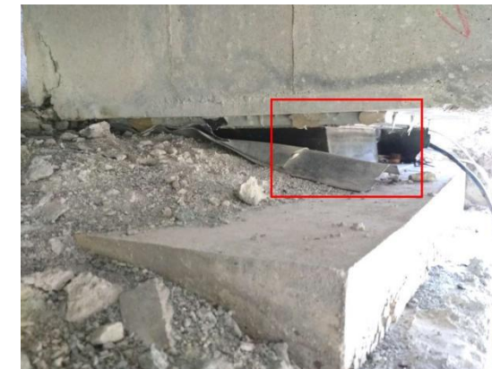
图 3-16: 桂阳大桥（上行）ZZ-18-18-1 支座：大桩号面纵向剪切；数量：1 个，角度：20°。
