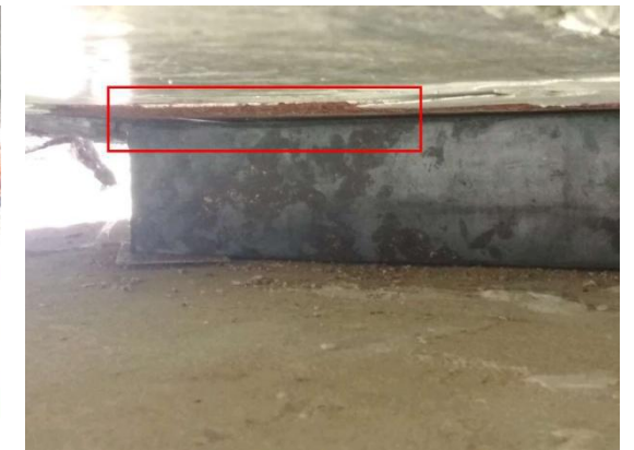
图 3-17: 下坊湾大桥（下行）ZZ-6-6-4 支座：大桩号面脱空；数量：1 个，高度：0.01m，百分比：15%。
