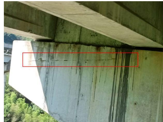
图 3-12: 楚溪大桥（上行）GR-11D 盖梁：距左侧 0.2m 处，小桩号面露筋；数量：1 处，长度：2.6m。
