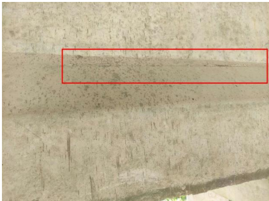
图 3-8：长兴大桥（上行）3-4T 梁：距 2 号墩 3m 处，马蹄左侧面露筋；数量：1 处，长度：0.5m。
