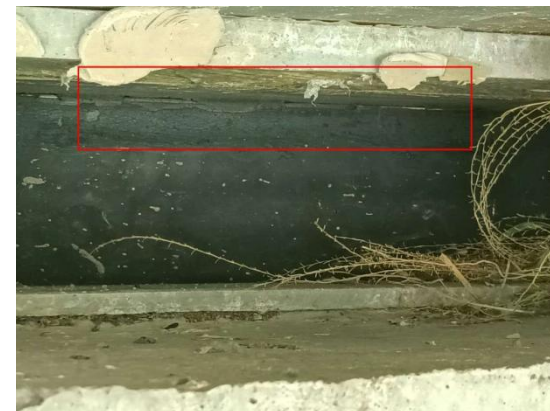
图 3-15: 桂阳大桥（下行）ZZ-14-14-3 支座：大桩号横向开裂；数量：1 条，长度：0.15m，宽度：0.8mm。
