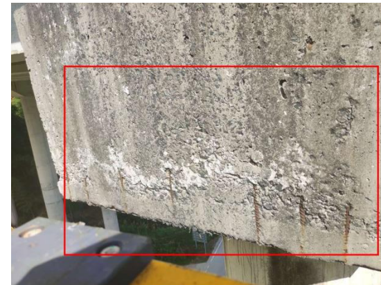
图 3-11: 桂阳大桥（上行）GR-5D 盖梁：右侧蜂窝、麻面；数量：1 处，长度：1m，宽度：2m。
