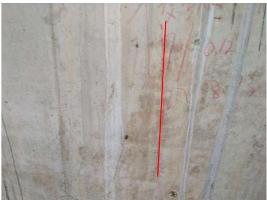
图 3-9：楚溪大桥（上行）GR-11D 盖梁：距右侧 5m 处，小桩号面竖向裂缝；数量：1 条，长度：0.7m，宽度：0.14mm。
