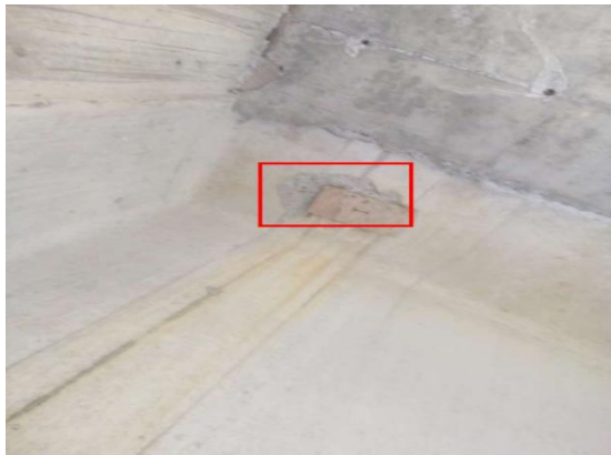
图 3-5：朱溪大桥（上行）5-1T 梁：距 5 号墩 0m 处，左翼缘板剥落；数量：1 处，长度：0.4m，宽度：0.3m。
