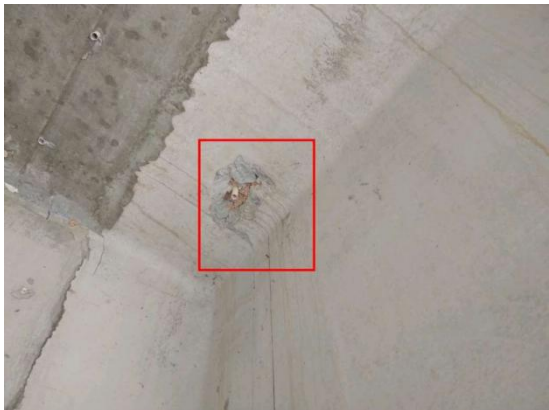
图 3-6：朱溪大桥（下行）1-5T 梁：距 0 号墩 0m 处，右翼缘板剥落；数量：1 处，长度：0.2m，宽度：0.15m。
