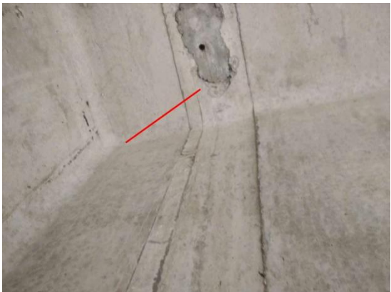
图 3-2：上清溪大桥（上行）1-2T 梁：距 1 号墩 0m 处，左翼缘板斜向裂缝；数量：1 条，长度：0.3m，宽度：0.12mm。
