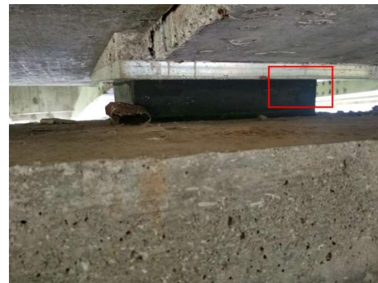
图 3-14: 长兴大桥（上行）ZZ-6-5-2 支座：大桩号面脱空；数量：1 个，百分比：20%，高度：0.015m。
