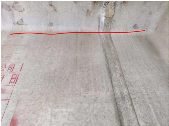
图 3-4：长兴大桥（上行）6-4T 梁：距 5 号墩 0m 处，左侧，翼板与腹板交接处纵向裂缝；数量：1 条，长度：1m，宽度：0.13mm。
