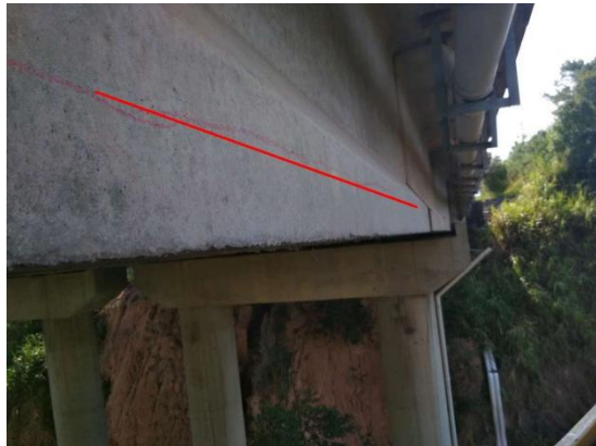
图 3-3：2-1T 梁：距 2 号墩 7m 处，马蹄左侧面纵向裂缝；数量：1 条，长度：0.07m，宽度：0.14mm。
