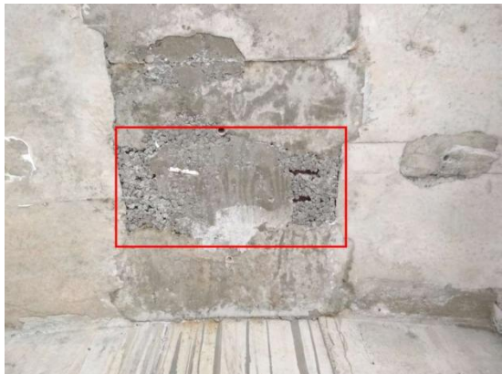
图 3-7：上清溪大桥（上行）2-2S 湿接缝：距 2 号墩 0m 处蜂窝、麻面；数量：1 处，长度：0.5m，宽度：0.4m。
