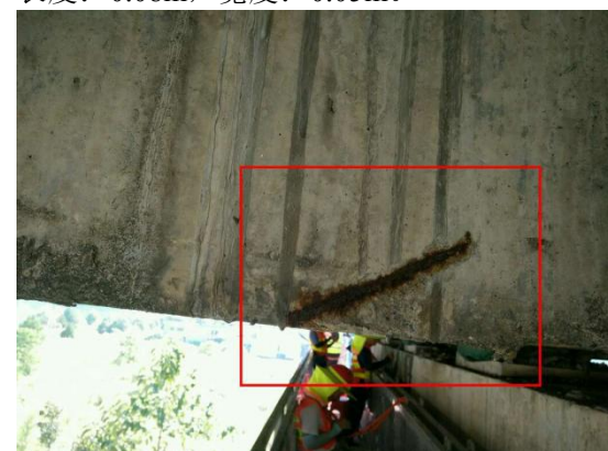
图 3-8: 积善特大桥（上行）13-5T 梁: 距 12 号墩 0.5m 处, 距下缘 0m 处, 马蹄左侧面露筋; 数量: 1 处, 长度: 0.15m。
