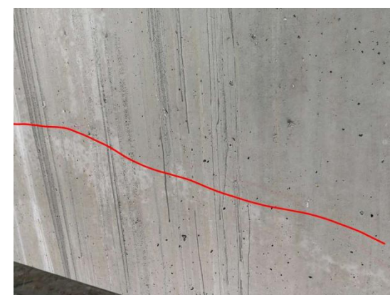
图 3-12: 积善特大桥（上行）GL-26D 盖梁: 距左侧 2m 起, 距上缘 1m 处, 小桩号面横向裂缝; 数量: 1 条, 长度: 4m, 宽度: 0.14mm。
