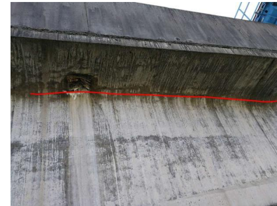
图 3-1: 积善特大桥（下行）19-5T 梁：距 19 号墩 0m 起，左翼缘板纵向裂缝；数量：1 条，长度：25m，宽度：0.22mm。
