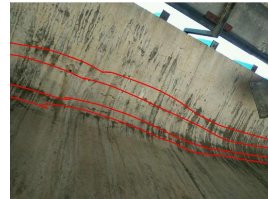
图 3-3: 积善特大桥（上行）10-5T 梁：距 9 号墩 0-8m 处，左侧，翼板与腹板交接处纵向裂缝；数量：4 条，长度：8m，宽度：0.13mm。
