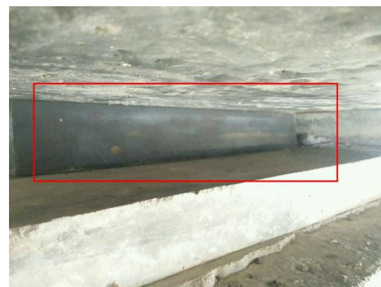
图 3-18： 积善特大桥（上行）ZZ-2-1-5 支座：纵向剪切；数量：1 个，角度：10°。
