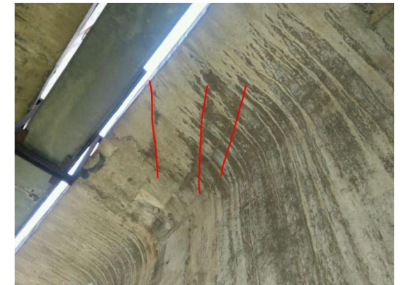
图 3-2: 积善特大桥（下行）21-1T 梁：距 20 号墩 0m 处，右侧，翼板与腹板交接处斜向裂缝；数量：3 条，长度：0.6m，宽度：0.14mm。
