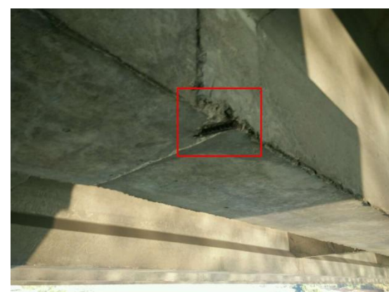
图 3-6: 积善特大桥（下行）24-2T 梁: 距 23 号墩 5m 处, 左翼缘板破损露筋; 数量: 1 处, 长度: 0.08m, 宽度: 0.05m。
