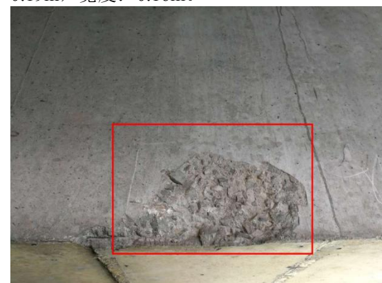
图 3-7: 积善特大桥（上行）13-3T 梁: 距 13 号墩 1m 处, 距下缘 0m 处, 马蹄左侧面掉角; 数量: 1 处, 长度: 0.2m, 宽度: 0.2m。
