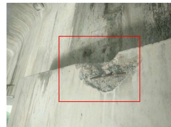
图 3-13: 积善特大桥（下行）GL-14D 盖梁: 距大桩号面 0.3m 处, 距上缘 0m 处, 右侧挡块掉角; 数量: 1 处, 长度: 0.35m, 宽度: 0.2m。
