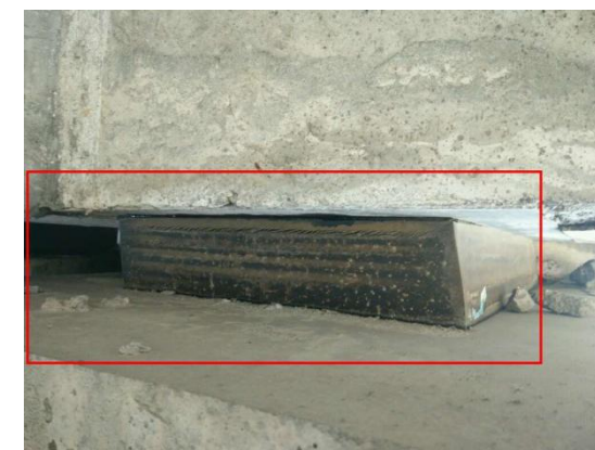
图 3-16: 积善特大桥（下行）ZZ-21-21-1 支座: 横向开裂; 数量: 3 条, 长度: 0.4m, 宽度: 0.2mm。
