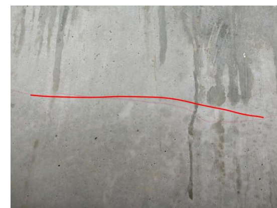
图 3-11: 积善特大桥（下行）GL-19D 盖梁: 距右侧 2m 处, 距上缘 1m 处, 大桩号面横向裂缝; 数量: 1 条, 长度: 1.2m, 宽度: 0.11mm。
