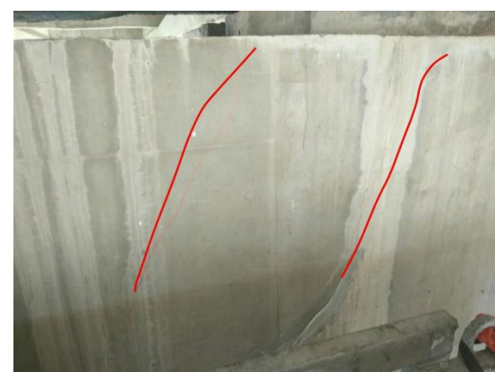
图 3-9: GL-10D 盖梁: 距右侧 2m 处, 距上缘 0m 处, 小桩号面斜向裂缝; 数量: 2 条, 长度: 0.6m, 宽度: 0.14mm。
