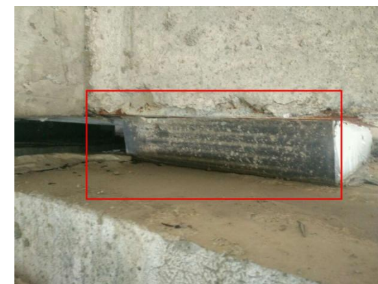
图 3-15: 积善特大桥（下行）ZZ-7-7-1 支座: 横向开裂; 数量: 5 条, 长度: 0.4m, 宽度: 0.2mm。
