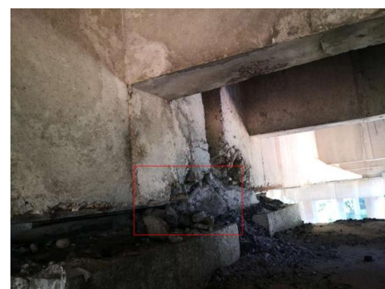
图 3-5: 积善特大桥（下行）7-4T 梁: 距 6 号墩 0m 起, 梁底破损露筋; 数量: 1 处, 长度: 0.19m, 宽度: 0.16m。
