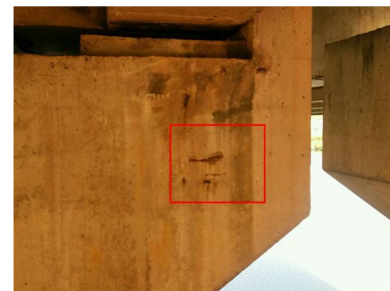
图 3-14: 积善特大桥（上行）GL-27D 盖梁: 距左侧 0.5m 处, 大桩号面露筋; 数量: 2 处, 长度: 0.2m, 宽度: 0.02m。
