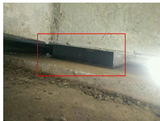
图 3-17： 积善特大桥（上行）ZZ-2-1-5 支座：纵向剪切；数量：1 个，角度：10°。
