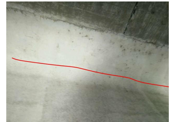
图 3-4: 积善特大桥（上行）19-5T 梁：距 19 号墩 10-14m 处，右侧，翼板与腹板交接处纵向裂缝；数量：1 条，长度：4m，宽度：0.15mm。
