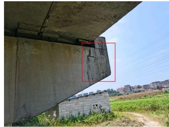
图 3-11: 先锋中桥（下行）GL-1D 盖梁：距左侧 0m 处，大桩号面露筋；数量：13 处，长度：0.5m。
