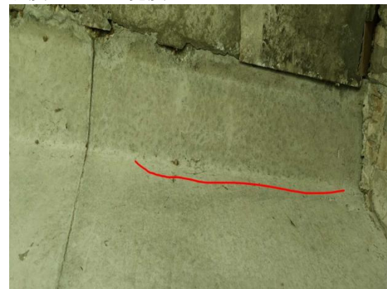
图 3-3: 黄石高架桥(上行)144-2 小箱梁: 距 144 号墩 0m 处, 翼板与腹板交接处纵向裂缝; 数量: 1 条, 长度: 0.8m, 宽度: 0.12mm。
