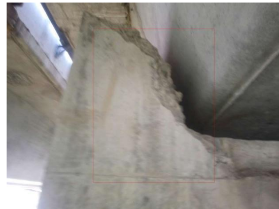
图 3-13: 江口高架桥（下行）GL-45D 盖梁：右侧挡块剥落；数量：1 处，长度：0.5m，宽度：0.2m。
