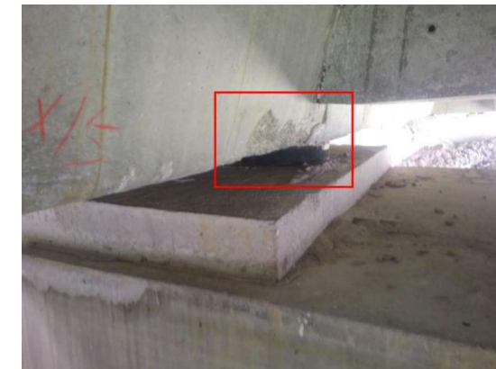
图 3-7: 惠上 1 号桥(上行)15-5 小箱梁: 距 15 号墩 0m 处, 右腹板剥落; 数量: 1 处, 长度: 0.4m, 宽度: 0.15m。
