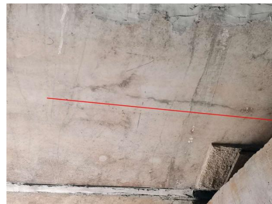
图 3-1: 燕子厝分离式桥(下行)1-13 空心板: 距 1 号墩 0m 处, 板底纵向裂缝; 数量: 1 条, 长度: 0.6m, 宽度: 0.12mm。
