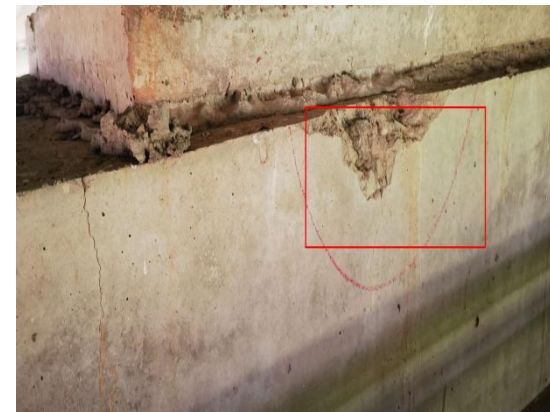
图 3-14: 黄石高架桥（下行）GL-100D 盖梁：距左侧 8m 处，左侧剥落；数量：1 处，长度：0.1m，宽度：0.1m。
