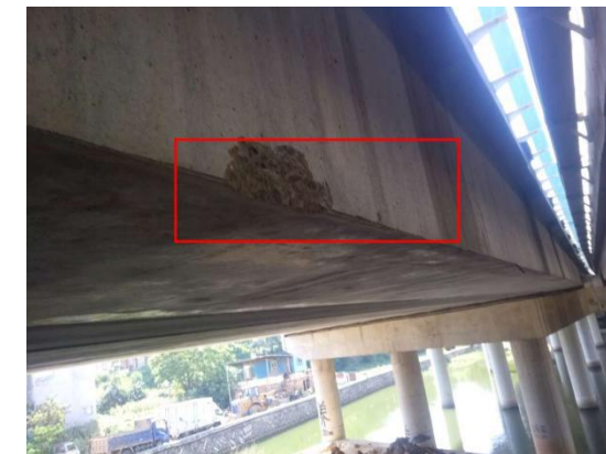
图 3-5: 湖柄分离式桥(下行)3-1 空心板: 距 2 号墩 1.5m 处, 右腹板剥落; 数量: 1 处, 长度: 0.15m, 宽度: 0.05m。
