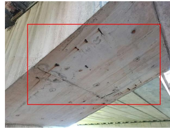
图 3-12: 先锋中桥（上行）GL-2D 盖梁：左侧露筋；数量：20 处，长度：0.4m。
