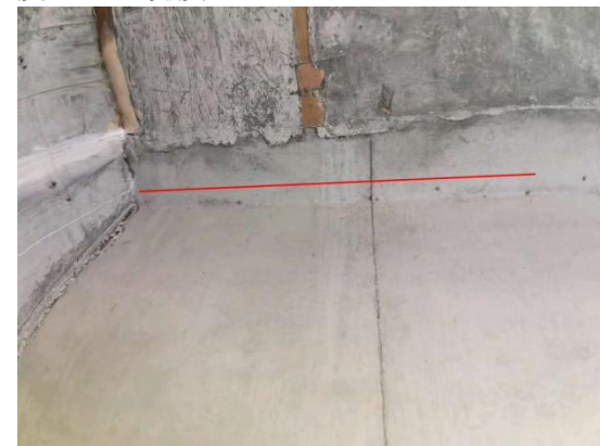
图 3-4: 黄石高架桥(下行)105-5 小箱梁: 距 104 号墩 0m 处, 右翼缘板纵向裂缝; 数量: 1 条, 宽度: 0.18mm, 长度: 1.5m。
