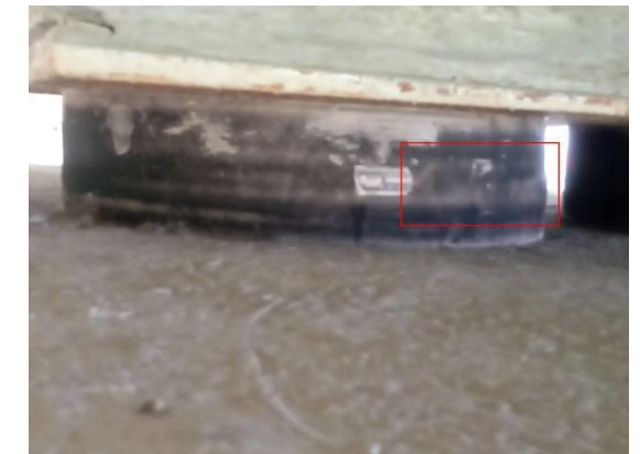
图 3-18: 黄石高架桥（下行）ZZ-12-12-3 支座：左侧外鼓；数量：1 个，长度：0.01m，宽度：0.01m。
