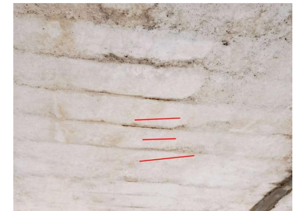
图 3-6: 湖柄分离式桥(上行)4-5 空心板: 距 4 号墩 2m 处, 板底露筋; 数量: 3 处, 长度: 0.1m。
