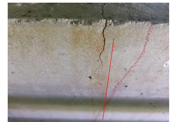
图 3-10: GL-100D 盖梁: 距左侧 3m 起, 大桩号面竖向裂缝; 数量: 1 条, 长度: 0.6m, 宽度: 0.14mm。
