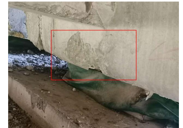
图 3-8: 黄石高架桥(下行)124-5 小箱梁: 距 123 号墩 0m 处, 右腹板剥落; 数量: 1 处, 长度: 0.2m, 宽度: 0.15m。
