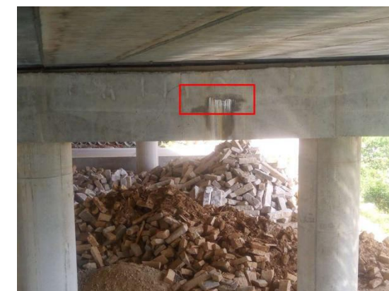
图 3-9: 湖柄分离式桥(下行)GL-3D 盖梁: 距右侧 6m 处, 距上缘 50m 处, 大桩号面横向裂缝; 数量: 1 条, 长度: 0.4m, 宽度: 0.16mm。
