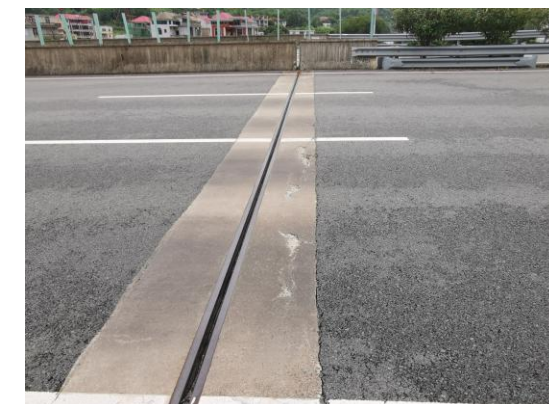
图 3-19: 狮亭中桥（下行）1f 伸缩缝：距左侧 4m 处，锚固区剥落；数量：4 处，长度：0.4m，宽度：0.1m。
