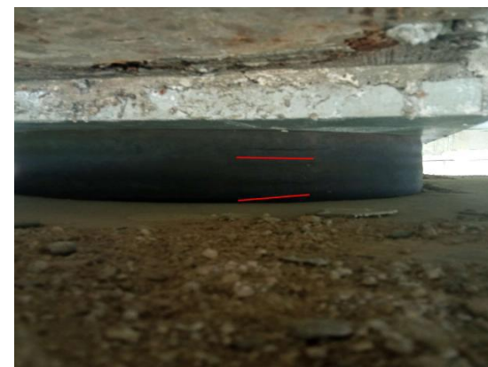
图 3-16: 龙西大桥（下行）ZZ-8-7-2 支座：左侧横向开裂；数量：2 条，长度：0.1m，宽度：0.18mm。
