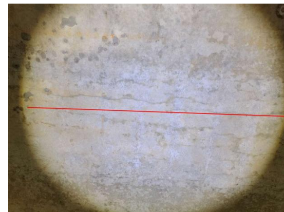
图 3-2: 先锋中桥(下行)3-6 空心板: 距 3 号台 1m 处, 板底纵向裂缝; 数量: 4 条, 长度: 9m, 宽度: 0.15mm。
